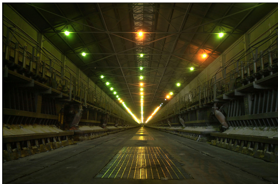
Figura 6: Visão Interna da Sala de Cubas de Poços de Caldas – MG
